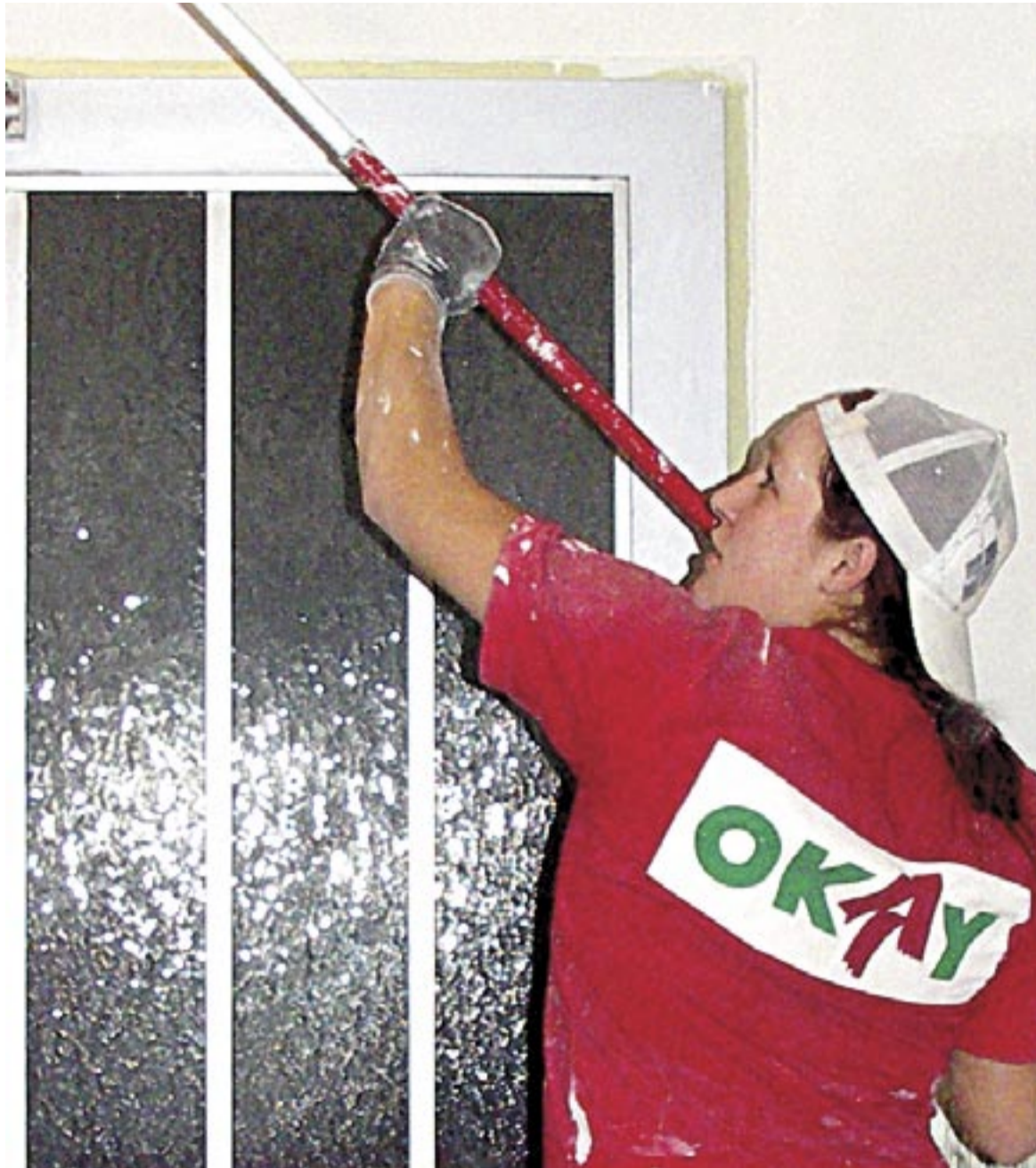
In der Renovierung von Sozialwohnungen und in Reparaturleistungen kann sinnvolle kommunale Arbeit geleistet werden.
